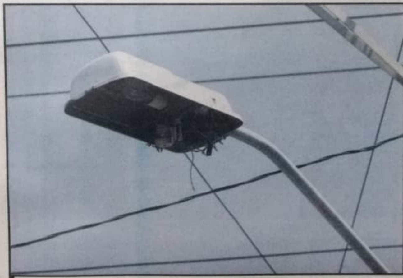
BUENA PARTE DE LAS LUMINARIAS EN LA CIUDAD SE ENCUENTRAN EN MAL ESTADO O SIMPLEMENTE NO SIRVEN.
