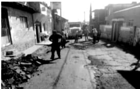
URUAPAN, MICH.- Para reparar las afectaciones que presenta el asfalto de las vías de comunicación primarias y secundarias del municipio se requiere de por lo menos 150 millones de pesos.
