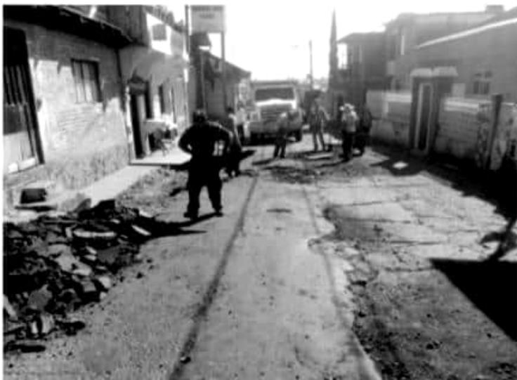
URUAPAN, MICH.- Para reparar las afectaciones que presenta el asfalto de las vías de comunicación primarias y secundarias del municipio se requiere de por lo menos 150 millones de pesos.
