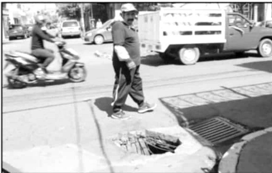
EN LA GUADALUPE VICTORIA HAY VARIAS REJILLAS Y REGISTROS ABIERTOS, QUE SE VUELVEN UN AUTÉNTICO PELIGRO.
