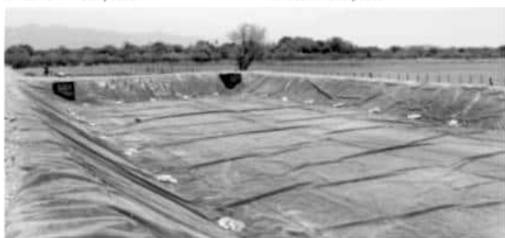
MORELIA, MICH.- Con una inversión superior a los 111.5 millones de pesos, la administración del Gobernador Silvano Aureoles Conejo, le apuesta a la cobertura de infraestructura hidráulica en toda la entidad.
