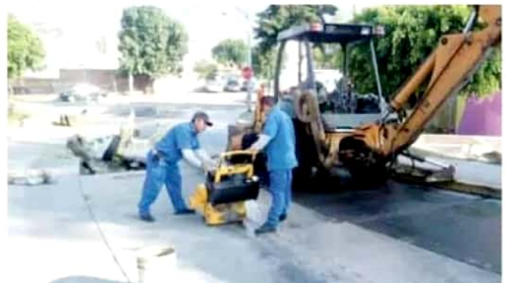
Este lunes continuaron los trabajos para concluir el cierre del socavón que se abrió el pasado viernes en la avenida La Joya y acelerar el proceso de fraguado. De acuerdo con el Organismo Operador de Agua Potable, Alcantarillado y Saneamiento de Morelia (Ooapas), la reparación de la línea sanitaria fue necesaria debido a que en la pasada administración se pavimentó dicha vialidad sin hacer la sustitución integral de la infraestructura de la zona. | CORTESÍA
