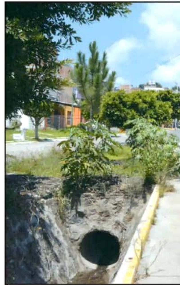
EL TRAZADO VIAL PELIGROSO QUE NO PERMITE UNA FLUIDA CAÍDA DEL AGUA SE M...
