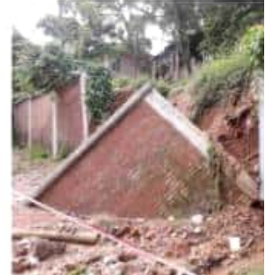
CD. LÁZARO CÁRDENAS, MICH.- Padres de familia de la Escuela Primaria "Juan Rulfo", dieron a conocer el colapso de la barda perimetral del plantel, la cual consideran un riesgo para los alumnos.
