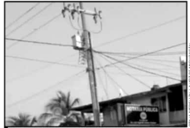
BUSCAN CONCLUIR LOS TRABAJOS PARA INSTALAR EL CABLEADO SUBTERRÁNEO QUE QUEDARON PENDIENTES DESDE HACE CASI UNA DÉCADA.
