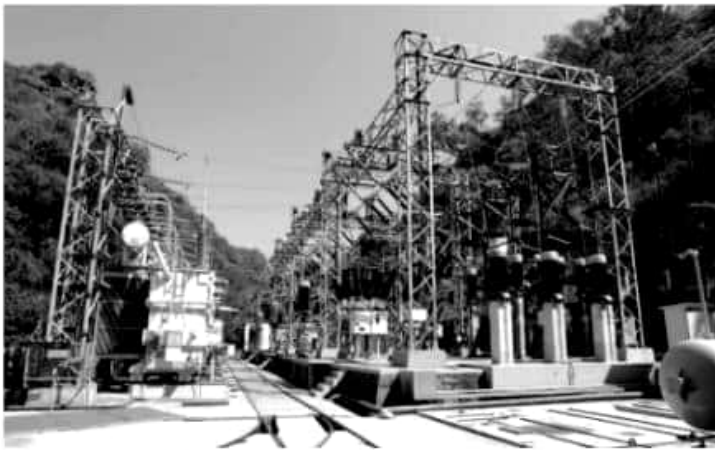
CONTEPEC, MICH.- El Gobernador del Estado, Silvano Aureoles Conejo, realizó una visita a la Central Hidroeléctrica Lerma Tepuxtepec, donde conoció la forma en la que trabajan los recursos naturales para su transformación en energía eléctrica.
