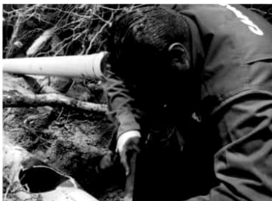
URUAPAN, MICH.- 15 metros de una tubería resultaron dañados afectando el suministro de agua potable en 5 colonias, así lo informó Miguel Paredes Melgoza,
