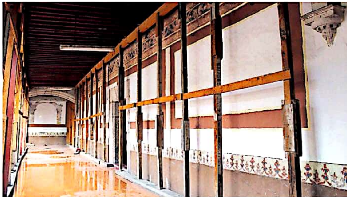
La viguería del techo es sostenida por una estructura de madera, que evita se caiga; el pasillo está parcialmente inundado por las goteras del techo. ALEJANDRA HERNÁNDEZ
