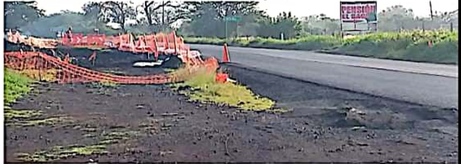
ECUANDUREO, MICH.- Esta semana se inició la construcción del camino de cuota Zamora-Ecuandureo, el cual conectará con la Autopista de Occidente.
