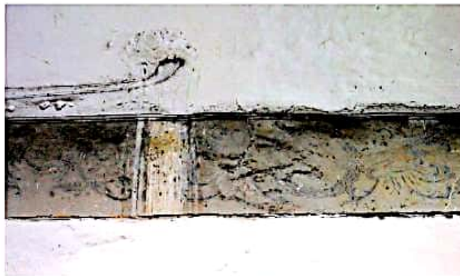
En la actualidad así se encuentran las grecas aludidas en la foto extraída del libro citado; se puede observar el daño por la humedad.
