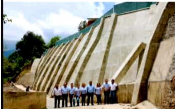
LOS REYES, MICH.- Concluyó la construcción del muro de contención en la ladera donde se ubica el preescolar "María Montessori", de la comunidad de Jesús Díaz Tzirío.
