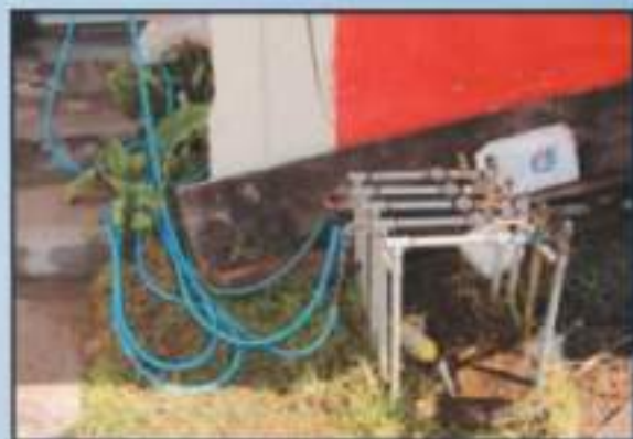
Acumulación de mangueras, otro aspecto que señala la problemática para poder hacer llegar agua a las viviendas para las necesidades básicas.
