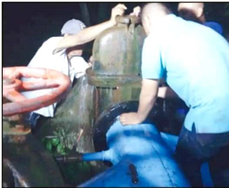
DÍA Y NOCHE ESTUVIERON LABORANDO EN EL MANTENIMIENTO DE LA VÁLVULA DEL ACUEDUCTO DE LC.
