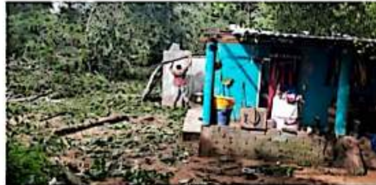
CD. LÁZARO CÁRDENAS, MICH.- A causa de la intensa lluvia y fuertes vientos, que se sucedieron acompañar de relámpagos, durante la noche del domingo, viviendas de las localidades de El Reino, Las Higueras y San Rafael presentaron daños.
