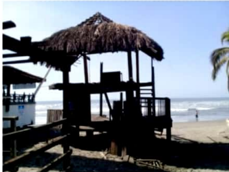
CD. LÁZARO CÁRDENAS, MICH.- Integrantes del Club de Salvavidas "Pelícanos" buscan rehabilitar la torre de salvavidas ubicada en Playa Eréndira.
