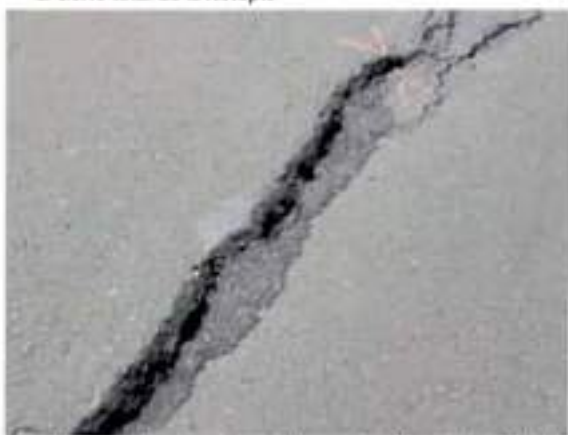
A simple vista se observa la grieta en el pavimento de la autopista Siglo XXI, cerca de Santa Casilda.
