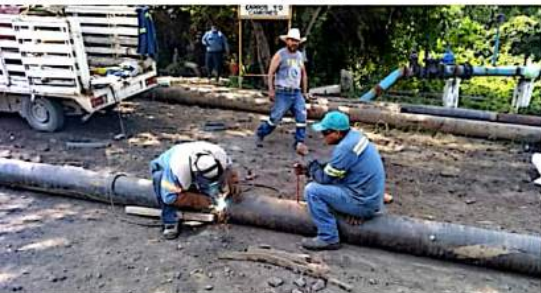
CD. LÁZARO CÁRDENAS, MICH.- Capalac dio a conocer que se tiene un avance del 60 por ciento en la reparación de la tubería que se dañó en el área de Minas por las lluvias y a más tardar la próxima semana estima esté regularizando el suministro de agua en la tenencia de La Mira.
