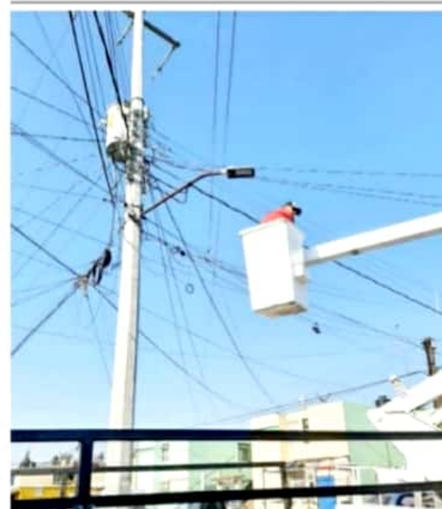
ZAMORA, MICH.- Como resultado de gestiones hechas por vecinos, se llevó a cabo la sustitución de varias luminarias en el fraccionamiento Infonavit Palo Alto.
