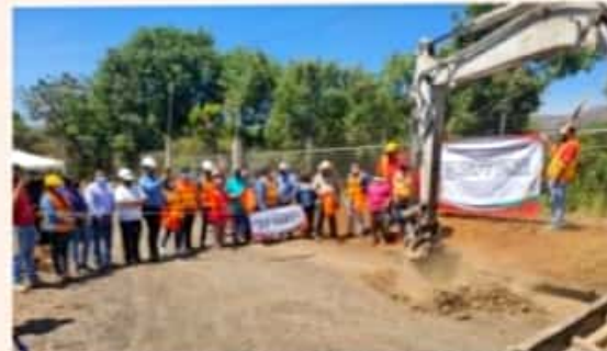
ZIRACUARETIRO, MICH.- El presidente José Rodríguez Baca acompañado de los regidores y vecinos del lugar, da el banderazo de inicio a la obra de pavimentación en la calle 21 de Marzo, en la localidad de Rancho Bonito.
