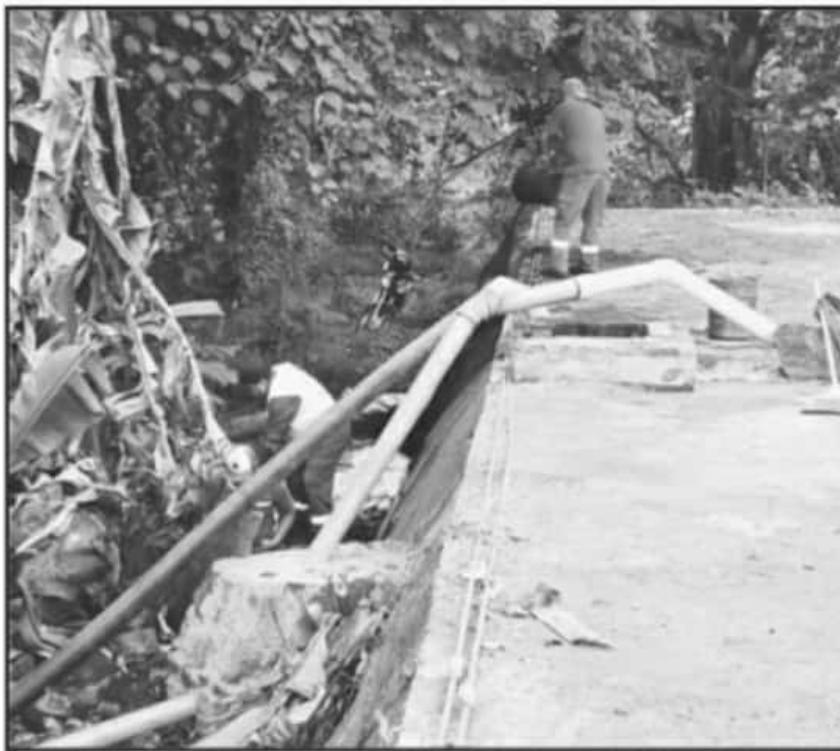
ESPERAN QUE EN EL INICIO DE ESTA SEMANA SE REINTEGRE EL ABASTO NORMAL DEL AGUA DEL SISTEMA "EL PESCADITO".
