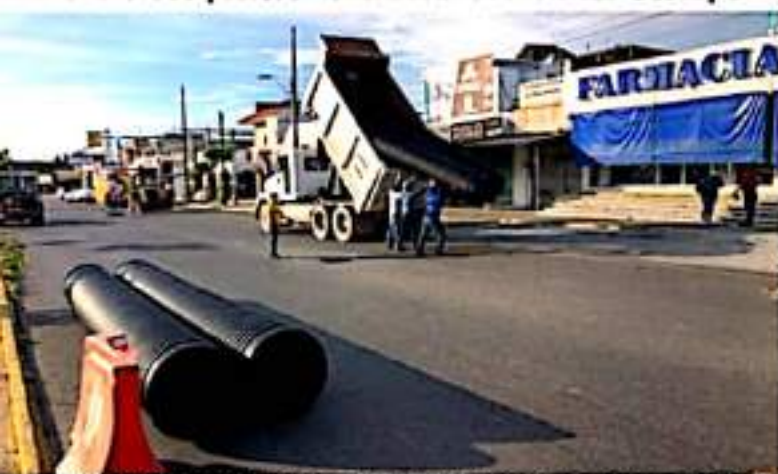
CD. LÁZARO CÁRDENAS, MICH.- La presidenta Itzé Camacho Zapata, instruyó al Capalac a iniciar el reemplazo de varios tramos de la tubería de drenaje la cual tiene más de 4 décadas, lo que ha generado socavones en la avenida Melchor Ocampo.
