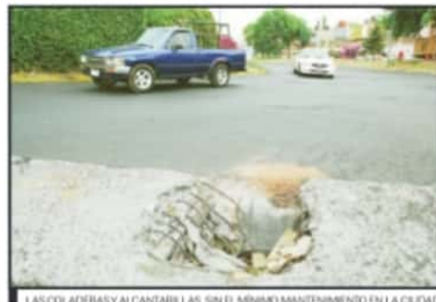
LAS COLADERAS Y ALCANTARILLAS, SIN EL MÍNIMO MANTENIMIENTO EN LA CIUDAD.
