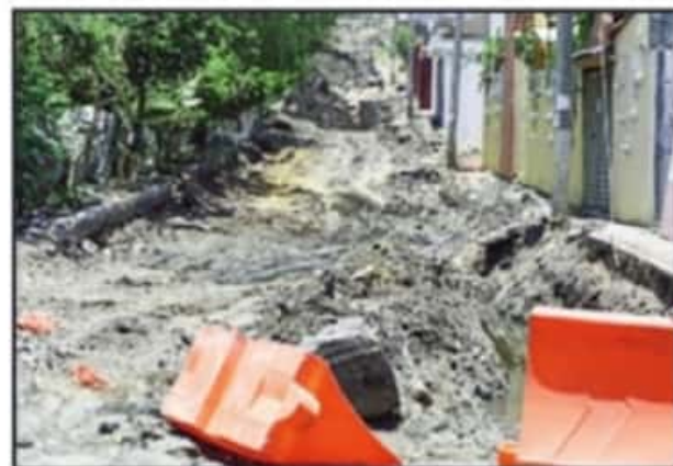
LAS OBRAS Y PROYECTOS EN ZONAS DE RIESGO, CON GRANDES REZAGOS.
