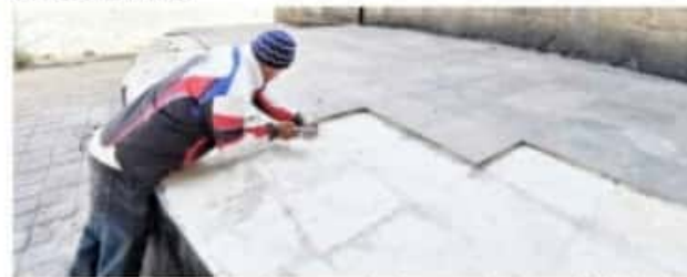
ZAMORA, MICH.- Los trabajos consistieron en la demolición de las banquetas en las inmediaciones del jardín construido en honor de José María Morelos.
