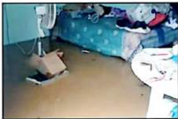
EL AGUA DE LAS LLUVIAS EN ALGUNAS VIVIENDAS SE METIÓ A LAS VIVIENDAS.
