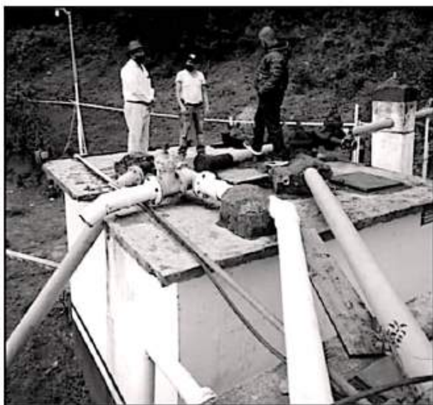
UN PROBLEMA ES LA INEFICIENCIA DE LAS BOMBAS DEL AGUA, LAS QUE CONSUMEN DEMASIADA ENERGÍA ELÉCTRICA.
