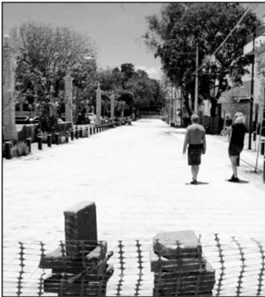
LA OBRA EN SANTA MARÍA SÓLO DURÓ UNAS CUANTAS SEMANAS ANTES DE QUE FUERA VANDALIZADO EL ADOQUÍN
