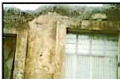
EL PASO DEL TIEMPO SE DEJA VER EN EL DETERIORO
