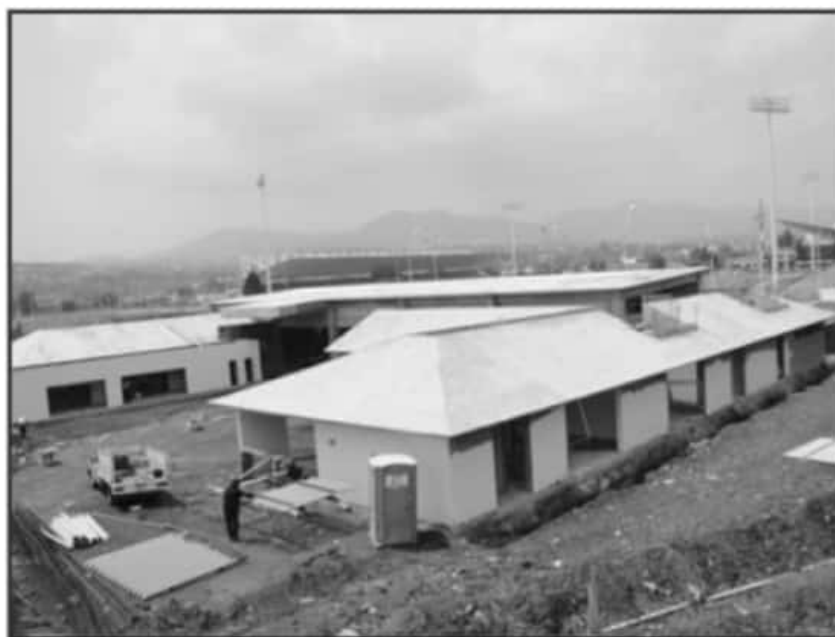
DESDE 2017 QUE LA OBRA DE LA CLÍNICA UNIVERSITARIA NO TIENE AVANCES RELEVANTES; URGEN AL RESCATE.
