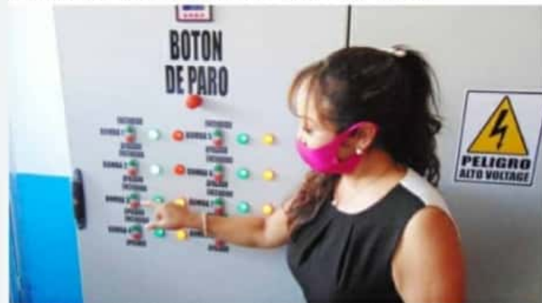
CD. LÁZARO CÁRDENAS, MICH.-La presidenta municipal María Itzé Camacho Zapiain, inauguró la operación de ocho bombas nuevas al interior del Capalac
