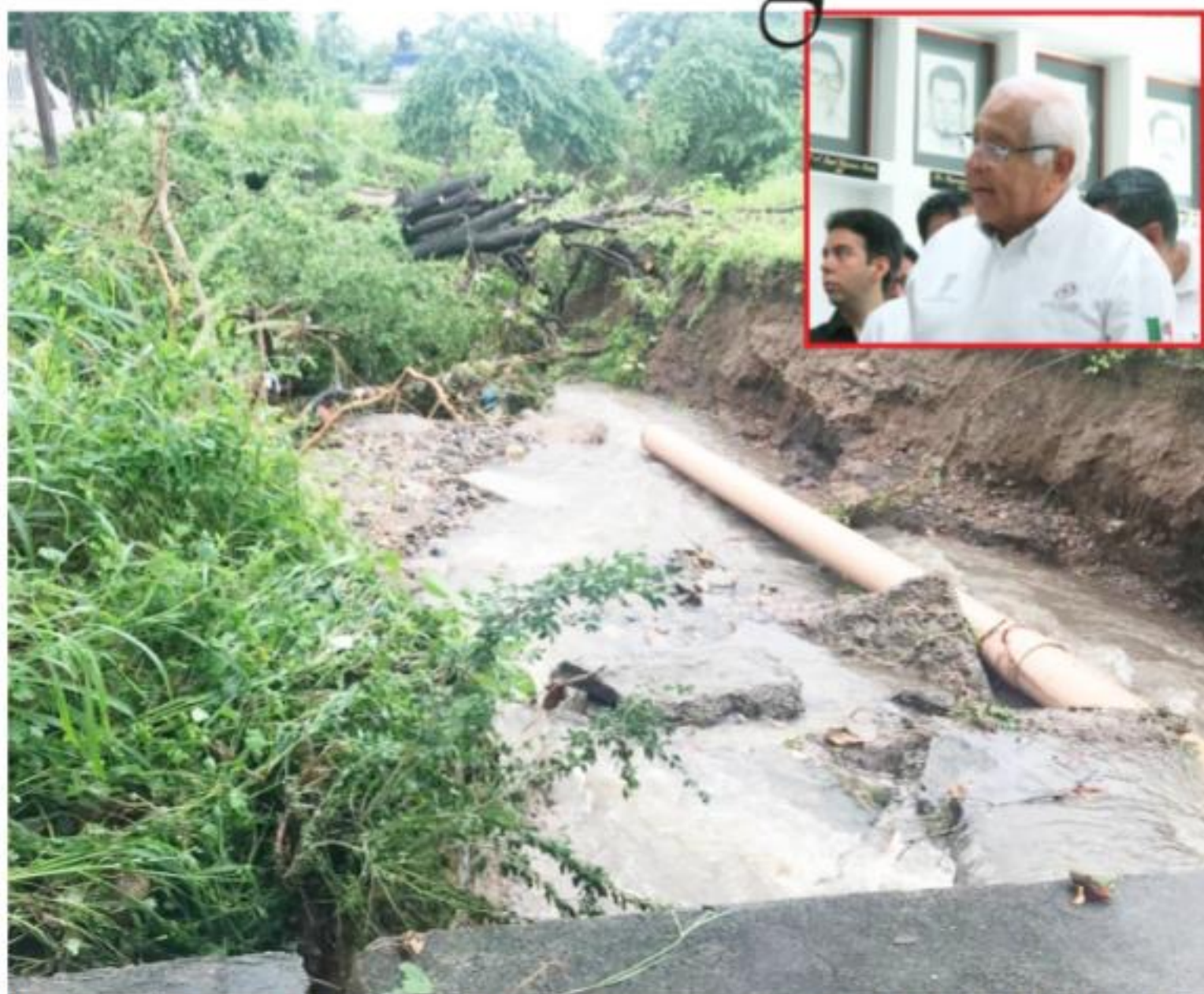
CD. LÁZARO CÁRDENAS, MICH.- Tras manifestar que el Fonden no aplica cuando los daños son en zonas irregulares y federales, como el caso del agrietamiento en la carretera federal, en el cruce de la avenida José María Morelos-Circunvalación Lázaro Cárdenas, el Director de la Unidad de Protección Civil en Michoacán, Pedro Carlos Mandujano, sugirió buscar alternativas de apoyo.
