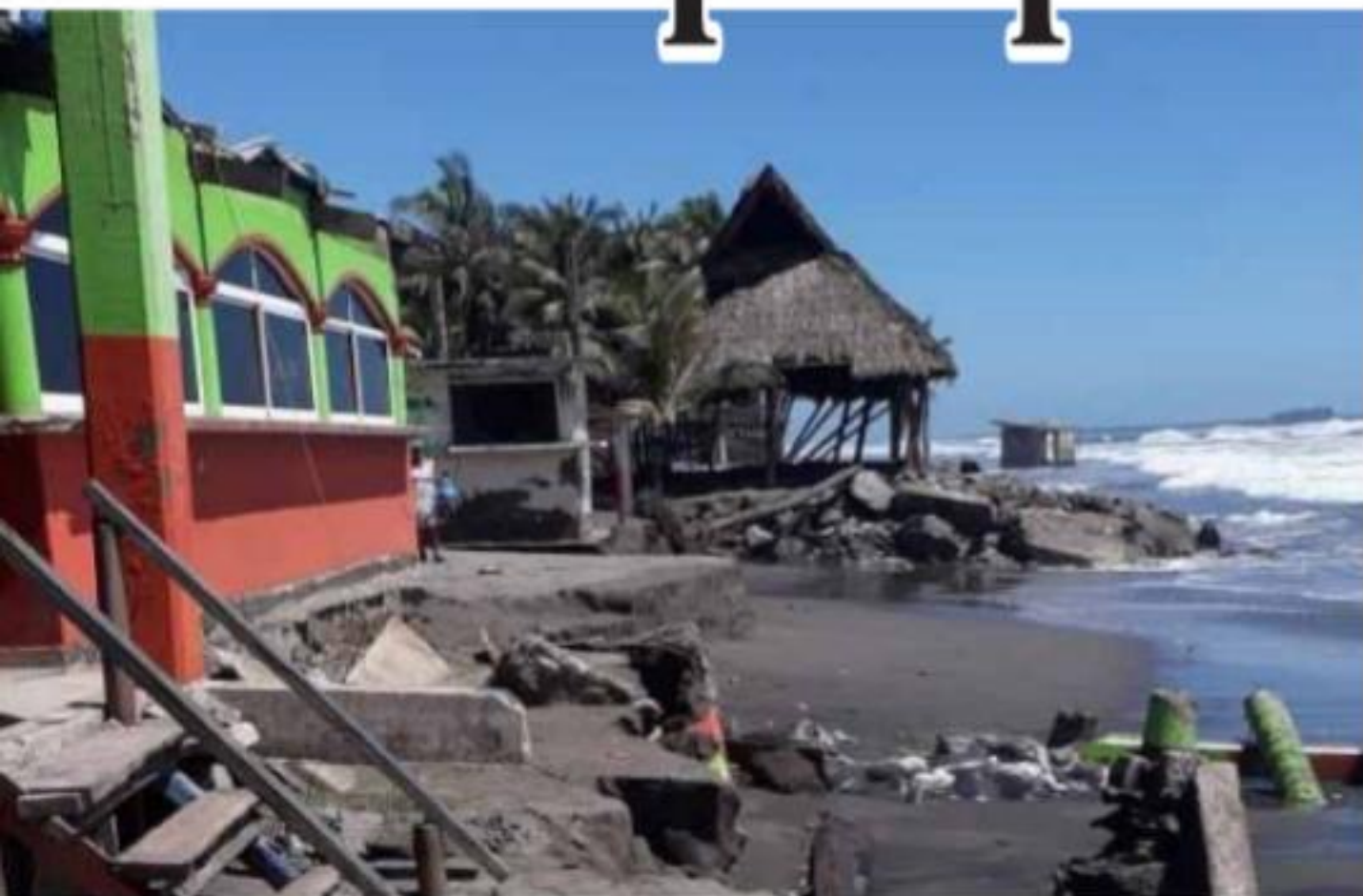
CD. LÁZARO CÁRDENAS, MICH.- Para evitar los frecuentes daños por los eventos climáticos a los prestadores de servicios situados sobre la zona federal en la playa Eréndira, proponen que se elabore un proyecto para construir una escollera o un muro de contención que proteja las enramadas.
