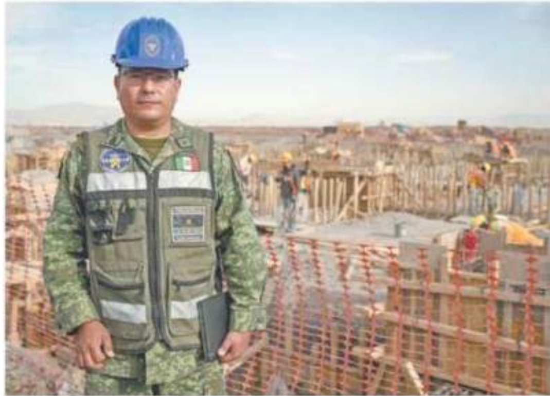
El mayor Miguel Ángel Guerrero Cruz dio a conocer que en este momento los trabajos registran un avance general de 2.29% en la etapa de cimentación y terracerías.
