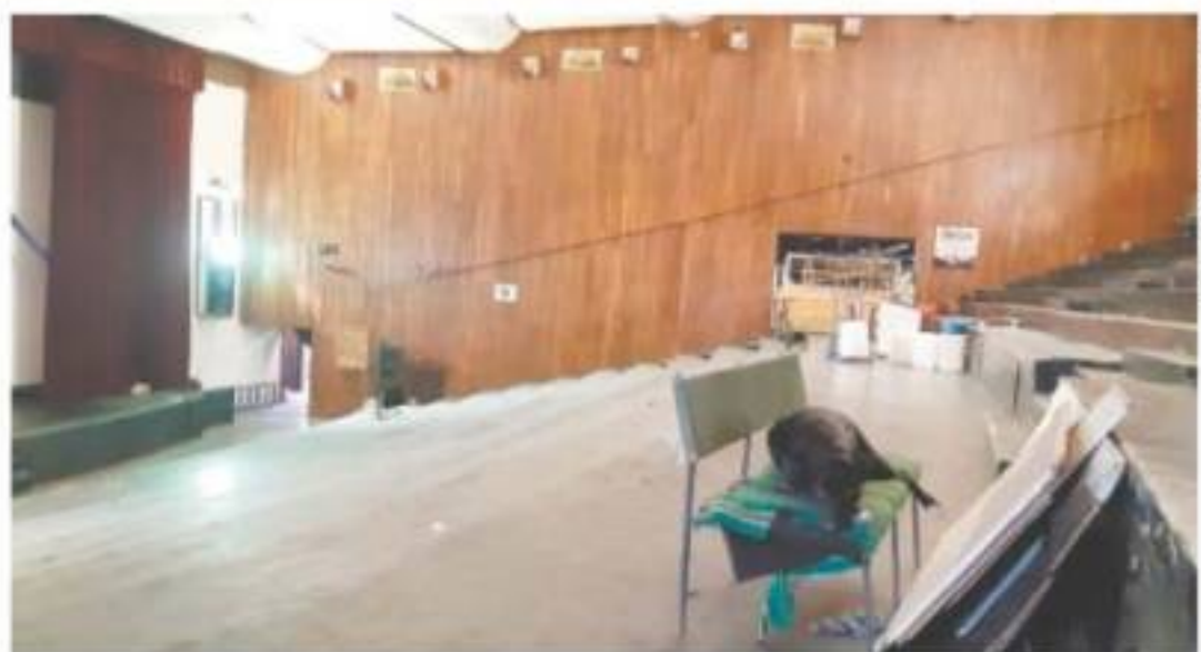
La sala de conciertos luce despojada hasta de sus butacas. Conserva las paredes recubiertas de madera y la acústica de su techo cóncavo, fracturado luego de los sismos de 2017.
