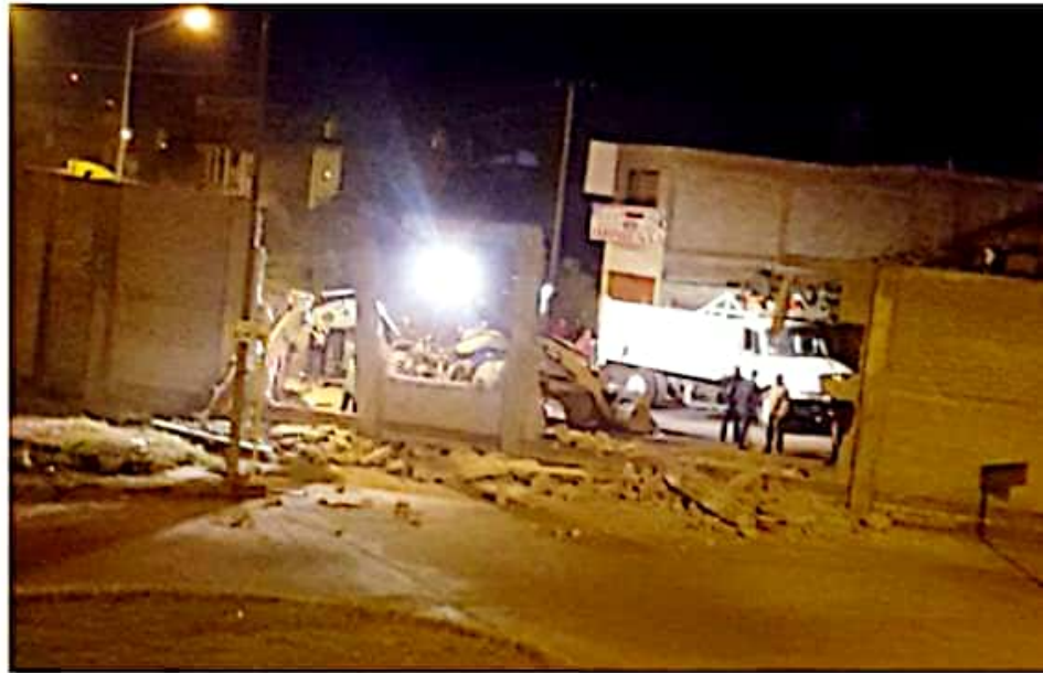
ZAMORA, MICH.- Con el uso de maquinaria pesada y el apoyo de la fuerza pública, autoridades municipales derribaron un muro que dividía al fraccionamiento Kuntani con otros asentamientos, lo que generó inconformidad entre los habitantes al asegurar que se trataba de una división para su seguridad.
