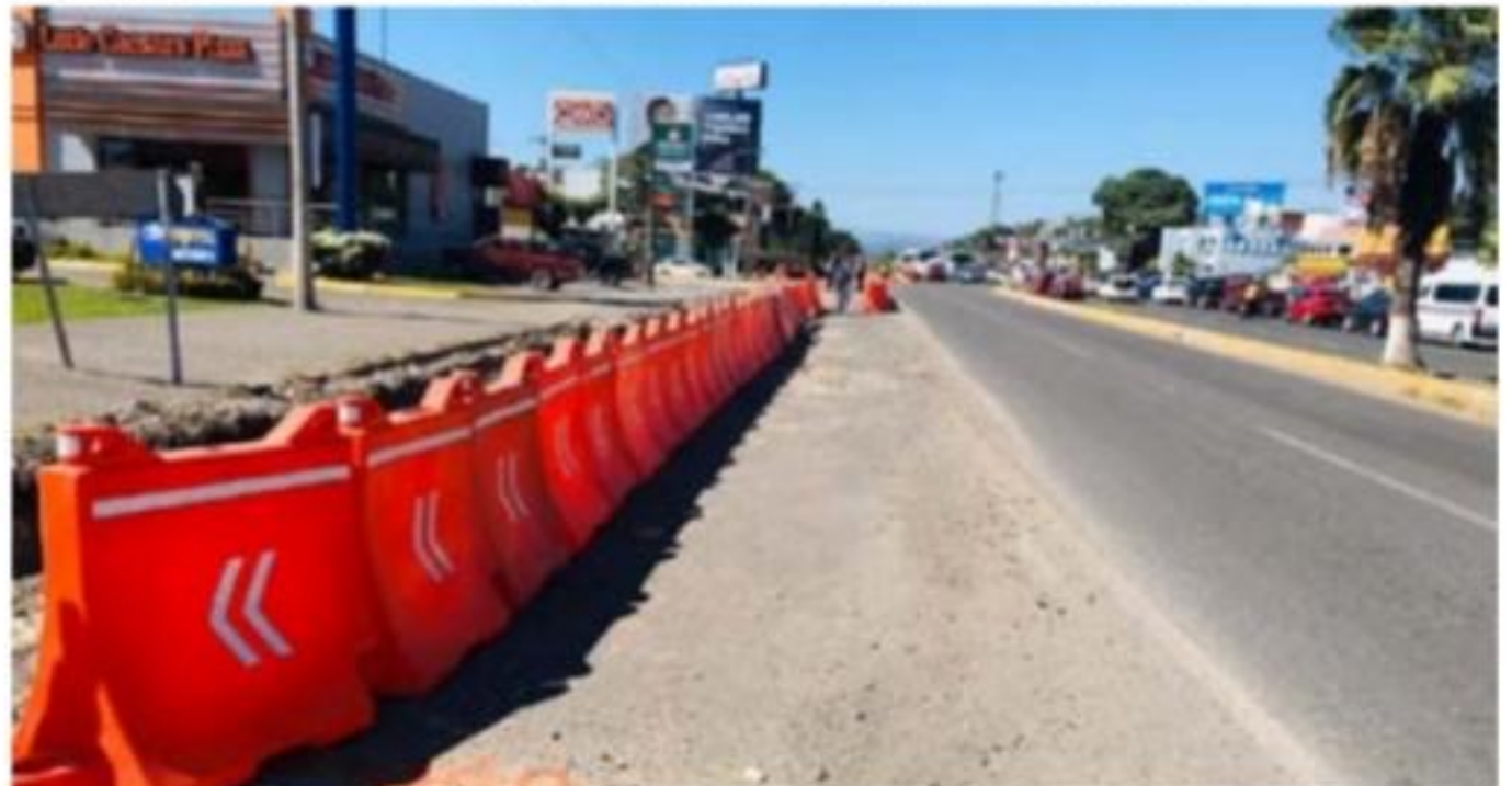
A raíz de la reunión de ayer entre transportistas y funcionarios federales, estatales y municipales, se permitió recorrer un poco hacia atrás las barreras que delimitan el carril lateral en el sentido cruce de Las Adelitas hacia el centro de la ciudad, a la altura del hotel City Express para dar mayor amplitud a las unidades del transporte urbano para el descenso y ascenso de pasajeros.
