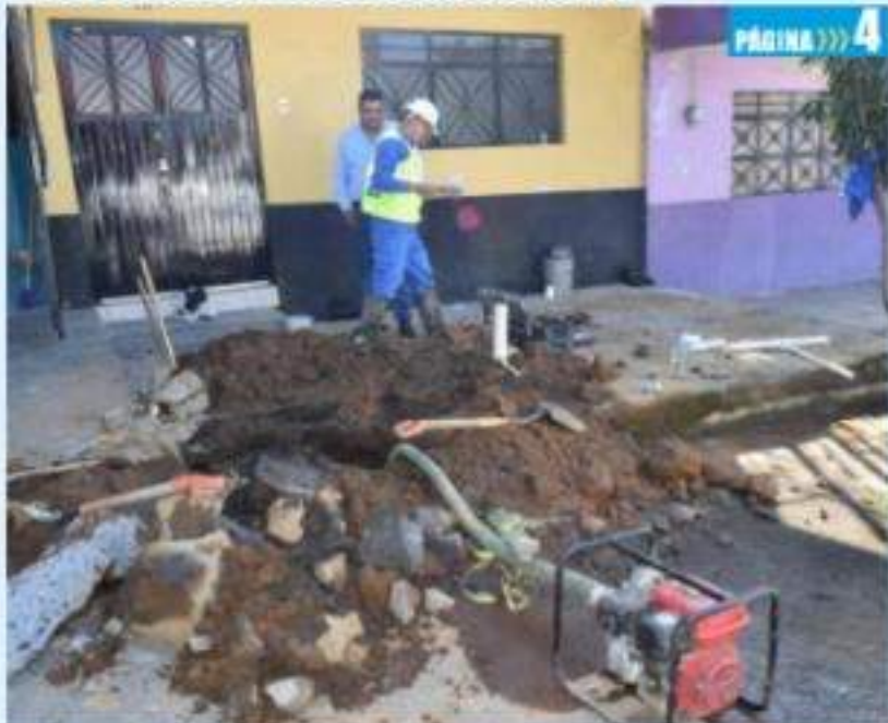
URUAPAN, MICH.- Personal de la Comisión de Agua Potable, Alcantarillado y Saneamiento de Uruapan (Capasu) atiende fugas del vital líquido que se han registrado durante las horas recientes.
