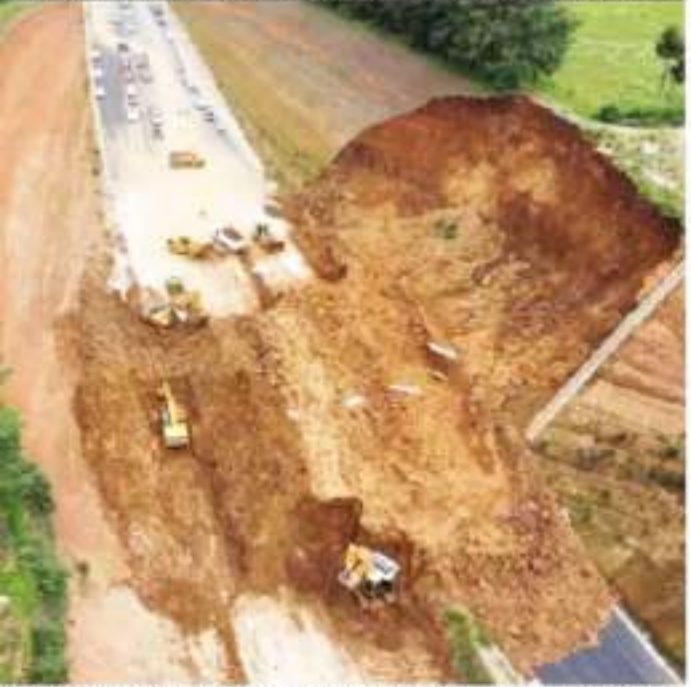
URUAPAN MICH.- La tarde del sábado, debido al deslave de un cerro, se cerró a la circulación la autopista Siglo XXI, a la altura del mirador a la laguna de Zirahuén, y aunque se comenzó a trabajar de inmediato en el retiro de la tierra, en la tarde de ayer aún quedaba mucha labor por hacer.
