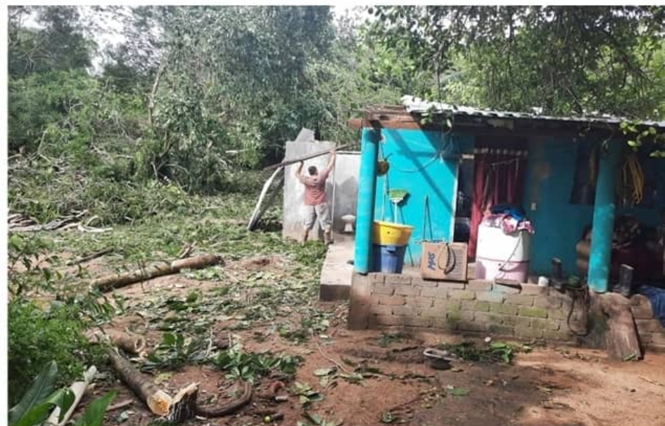
CD. LÁZARO CÁRDENAS, MICH.- A causa de la intensa lluvia y fuertes vientos, que se hicieron acompañar de relámpagos, durante la noche del domingo, viviendas de las localidades de El Reino, Las Higueras y San Rafael presentaron daños.
