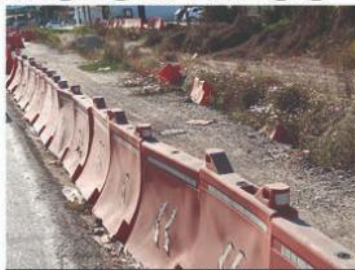
A poco más de un año de haberse licitado e iniciado la obra del Distribuidor Vial, la misma se encuentra en completo abandono y sin certeza de su construcción.
