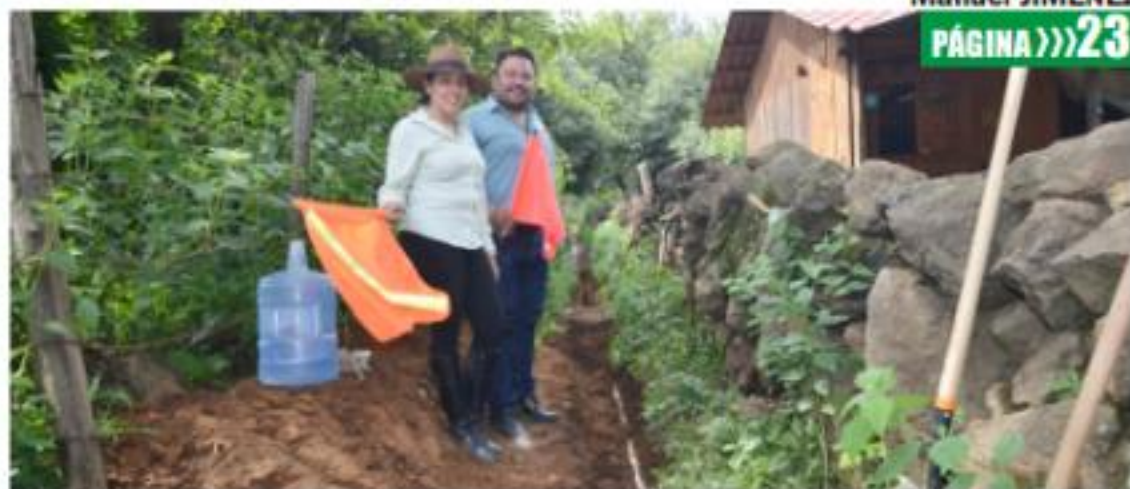
SAN ÁNGEL ZURUMUCAPIO, MPIO. DE ZIRACUARETIRO, MICH.- El presidente municipal, José Rodríguez Baca, conjuntamente con la directora de Obras Públicas, Erandi Esmeralda Sánchez Álvarez, dan el banderazo de inicio de obra de la rehabilitación de la red de agua potable en esta comunidad.
