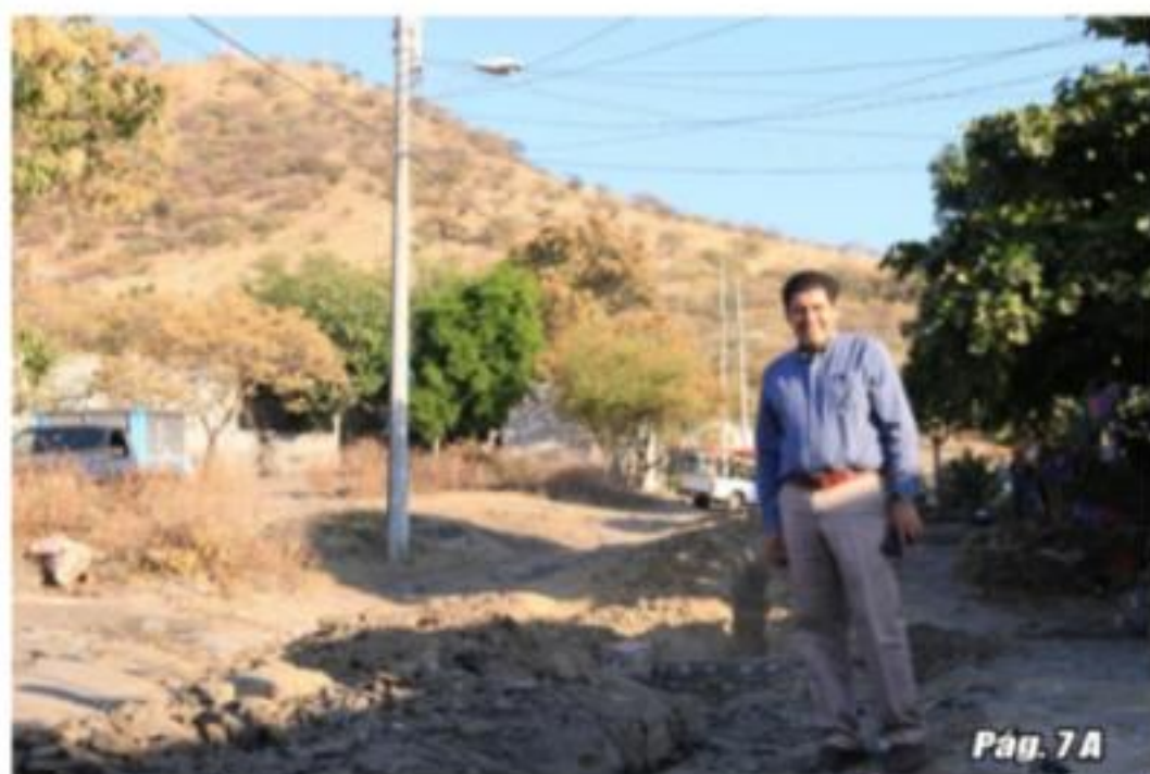
NUEVA ITALIA, MPIO. DE MUGICA.- El presidente municipal Raymundo Arreola Ortega, supervisó los trabajos de la obra de drenaje en la calle Emiliano Zapata de la colonia Agrarista.
