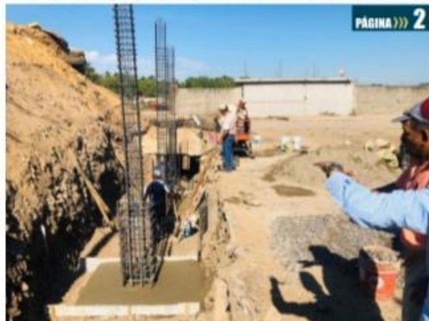
CD. LÁZARO CÁRDENAS, MICH.- La presidenta municipal, María Itzé Camacho Zapalán informó que la Secretaría de Obras Públicas Municipales construye una rampa para la recolección de basura.
