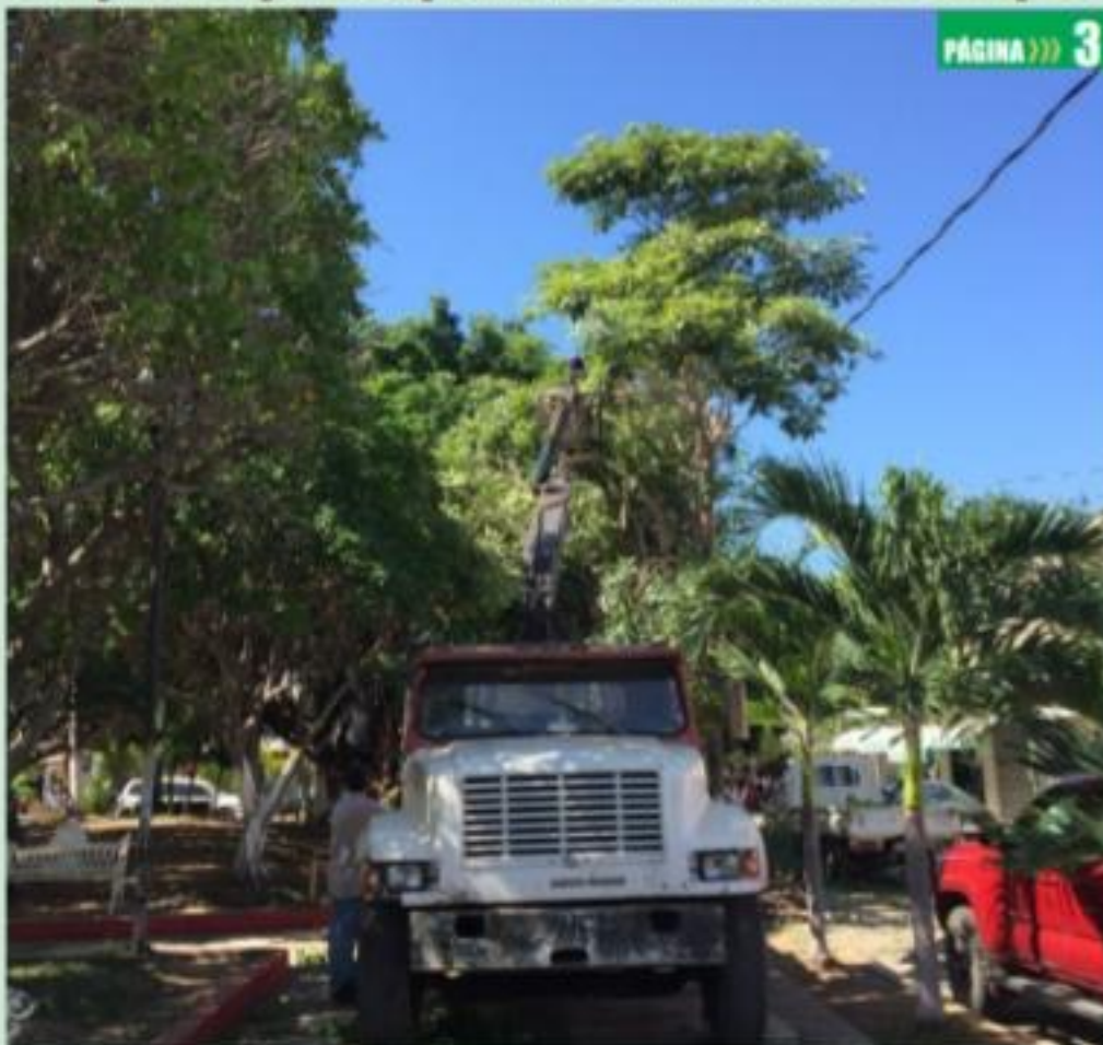
CD. LÁZARO CÁRDENAS, MICH.- Este jueves, culminaron los trabajos de embellecimiento a la plaza principal de la tenencia de Caleta de Campos.
