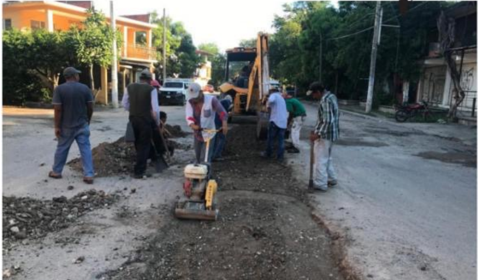
CD. LÁZARO CÁRDENAS, MICH.- El jefe de esta tenencia, Abel Toledo Serrano, manifestó que es debido a la falta de recursos en el ayuntamiento porteño, que se complica avanzar en la reparación y rehabilitación de los drenajes colapsados en Las Guacamayas.
