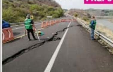
URUAPAN, MICH.- Una gran grieta es la responsable de que a partir de ayer se lleven a cabo cortes viales, en la autopista Siglo XXI.
