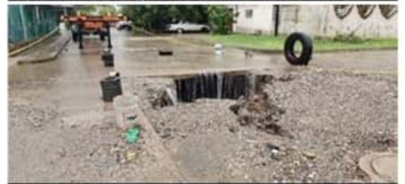
El socavón generado ayer en la tenencia de Guacamayas.
