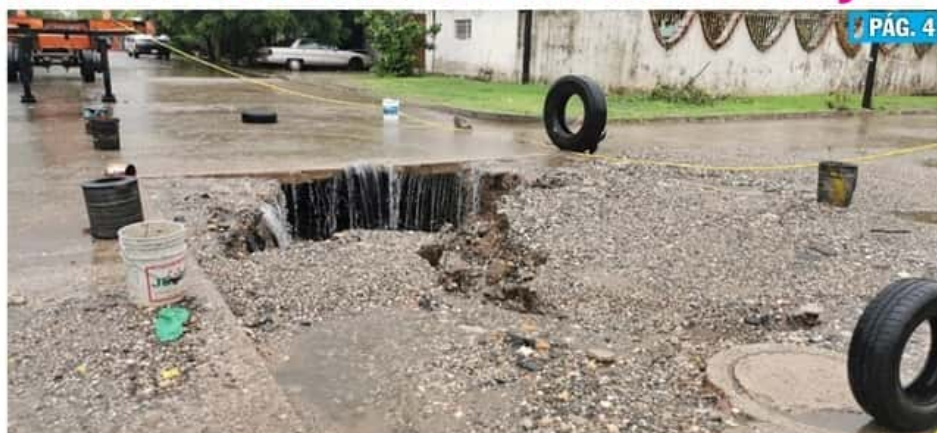
CD. LÁZARO CÁRDENAS, MICH.- Un socavón se generó este domingo en la tenencia de Las Guacamayas.
