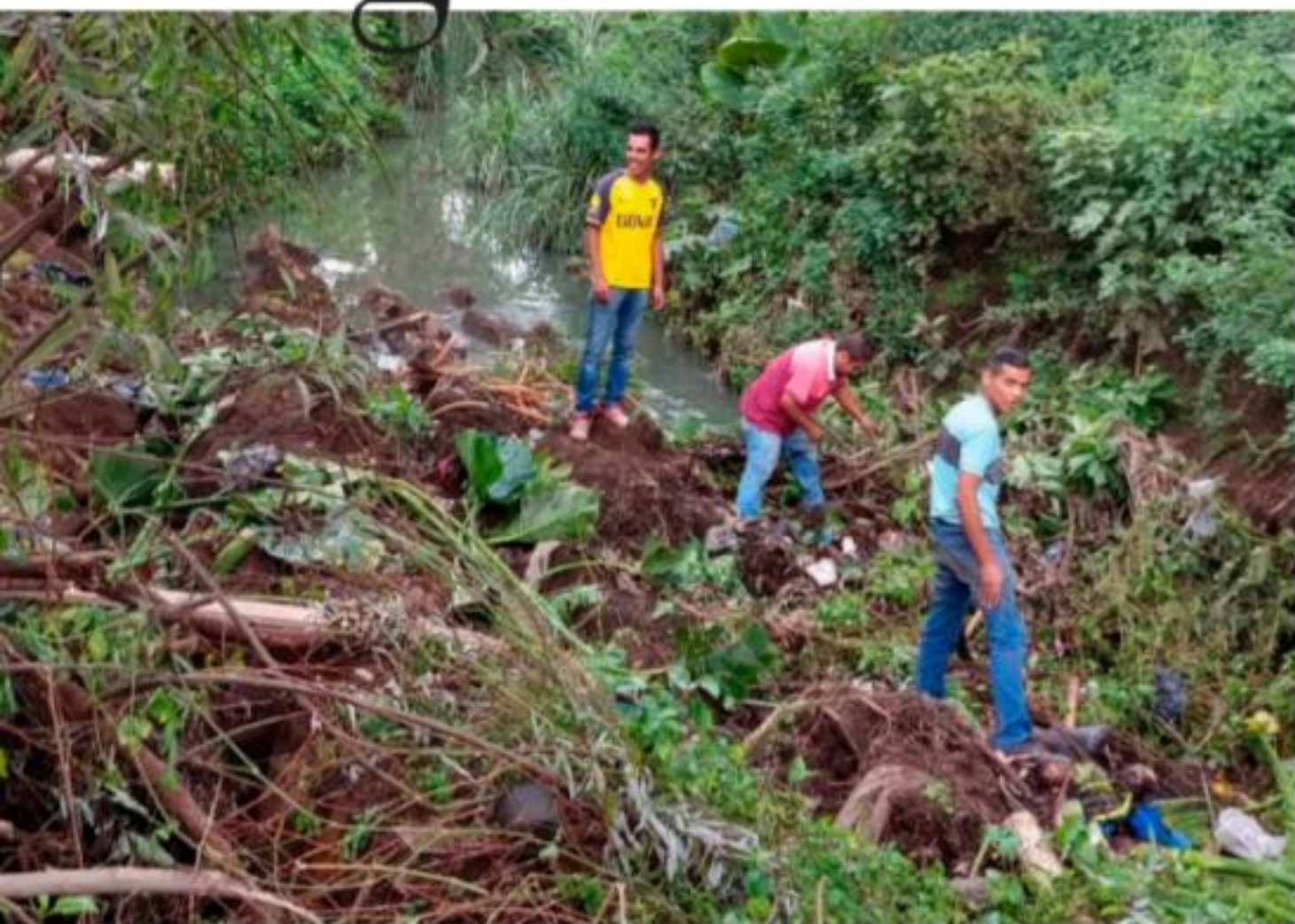
URUAPAN, MICH.- Son evidentes los riesgos que amenazan a 30 familias vecinas de la calle Maravillas en la colonia La Mora, tras el derrumbe de una parte del muro de contención del canal "El Padre".
