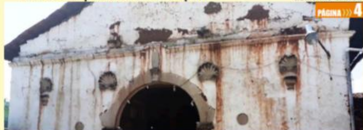
URUAPAN, MICH.- Graves niveles de deterioro, desde su fachada, paredes internas, pinturas y estructura, presenta el antiguo templo de San Francisco, construido durante el siglo XVI.
