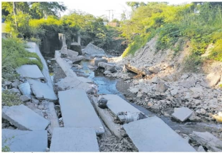
CD. LÁZARO CÁRDENAS, MICH.-Canales con un deterioro importante que atentan contra más de 30 colonias Las Guacamayas.
