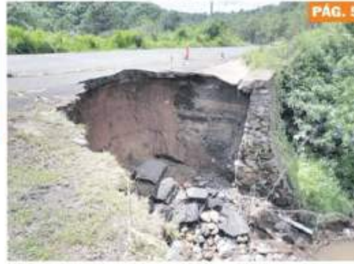
URUAPAN, MICH.- Al borde de la carretera Uruapan-Ziricuarétiro está este socavón, que es un peligro para los automovilistas; los ejidatarios de Zirimícuaro afirman que se encuentra en territorio de Uruapan, por lo que repararlo es tarea de...
